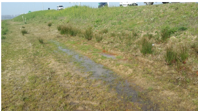
Foto: Verzadiging teen talud.
