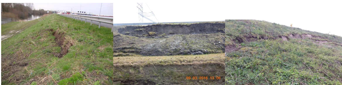
Foto: Afschuiving van talud.
