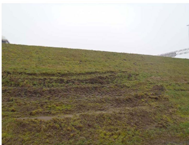
Foto: Maaischade aan afdeklaag.
