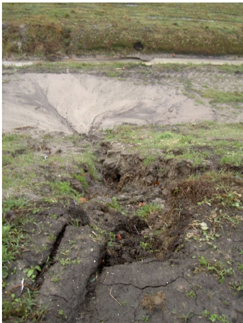
Foto: Erosie van afdeklaag.
