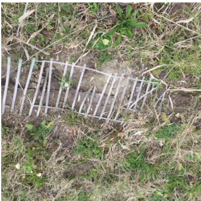
Foto: Geogrids zichtbaar in teen talud en scheurvorming in de afdeklaag.
