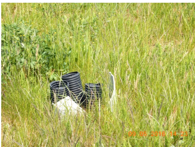
Foto: Mantel om drainageleidingen beschadigd.
